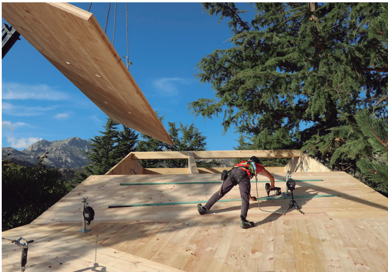
Imagen 2. Montaje de forjado de cubierta de madera CLT. Vivienda unifamiliar en Mataelpino (Madrid)
